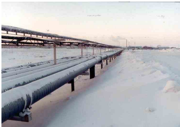
TUBATURE DI UN GASDOTTO IN RUSSIA SIBERIA (Moscow - 2006-01-02, Ropi)
